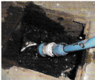
▲ 水の溜まった埋設型散水栓
